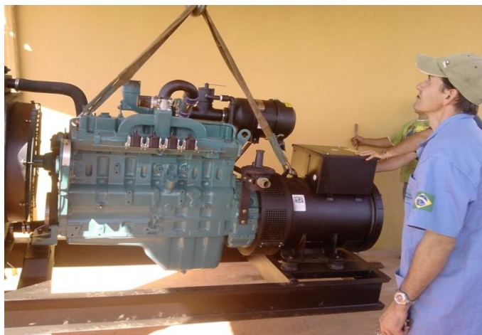
Figura 10 - Motogerador a Biogás para produção de energia renovável independente
