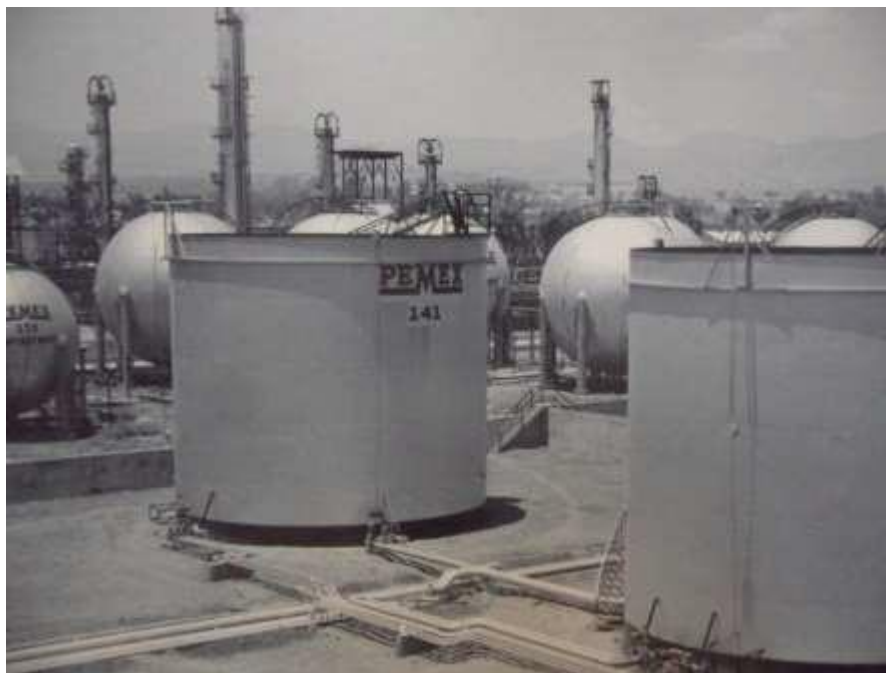
Tanques contenedores de diversos derivados de petróleo.
