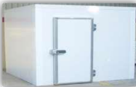
Imagen 18. Cuarto de frío
